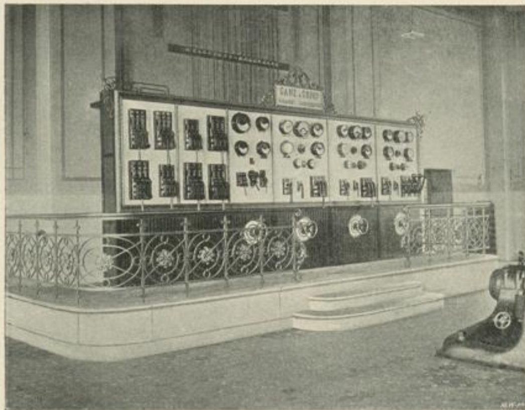
Schalttafel in der elektrischen Centrale der Locomotivfabrik.
